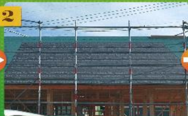
下葺材として太陽光設置面には透湿ルーフィングを張ります
