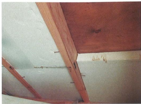
押出法ポリスチレンフォーム板(XPS)を剥がすと、北側の屋根の野地合板がびっしょりぬれて、クギがさびていた。XPSに防湿シートを施していなかった。東北地方に建つ築半年の屋根断熱の住宅。60ページの図④に該当 (写真：本誌)
