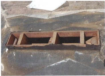
東京都内に建つ築27年の住宅。北面の野地合板だけが腐 食し、踏みと危険な状態だった。天井断熱で、軒先と棟に 吸気孔と排気孔を設けていた
