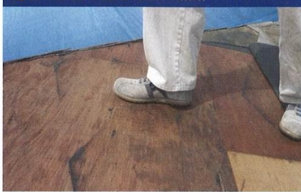
■ 野地合板の北側外面の結露 (10月号の本連載)
