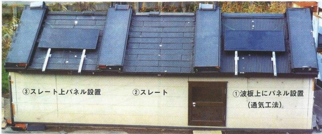
(写真1) 太陽光パネル設置後の小屋裏環境の比較調査を行った実験棟 (2012年)
