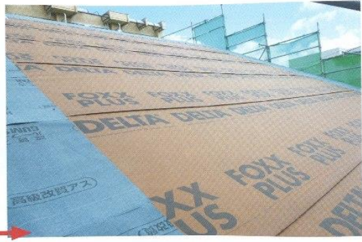
② 太陽光パネルが載るところ以外はゴムアスをはる
