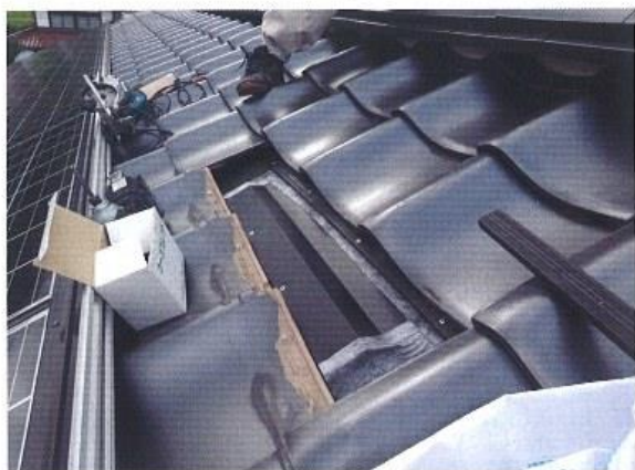
(写真7) 屋根の平部に設けた排気口
