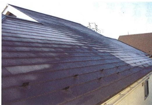
スレート屋根の表面に結露が発生している東京都世田谷区に建つ住宅。上図①に該当 (写真・資料：特記以外は屋根システム総合研究所)
