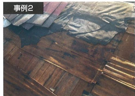
事例3 軒先に吸気孔を設けていた、東京都内に建つ築20年の住宅。北面 のアスファルトルーフィングを剥ぐと野地合板がぬれていて、ル ーフィングも野地合板も劣化でぼろぼろになっていた
